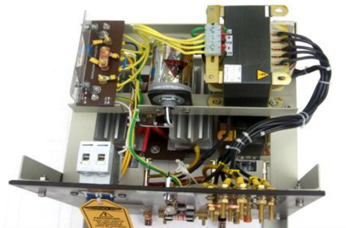
Foto 7 – Detalle Interior Rectificador Enfriado por Aire.
