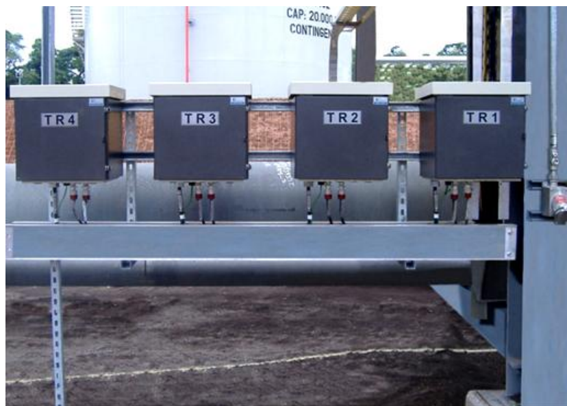
Foto 5 – Rectificadores para PC del Fondo de 4 Tanques de 20,000 bbls
