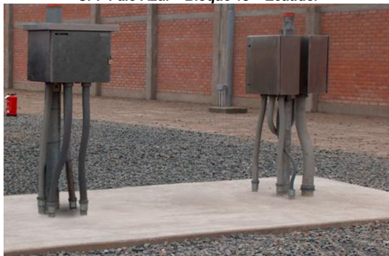
Foto 6 – Rectificador y Unidad de Monitoreo Remoto para Scada Proyecto Camisea - Perú.
