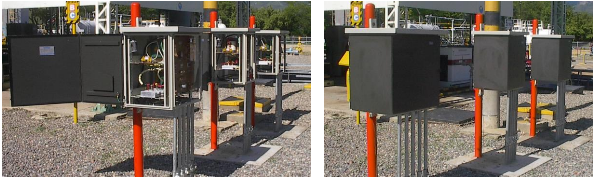
Foto 1 y 2 – Rectificadores con Gabinete Abierto y Cerrado en Petrobrás – Colombia.
